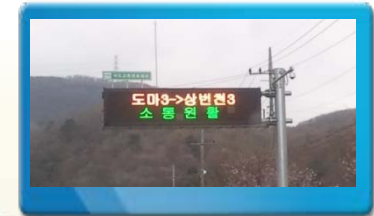
VMS (Variable Message Sign)
